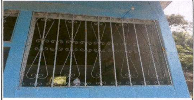
Foto 2: Barandas despintadas y en mal estado
